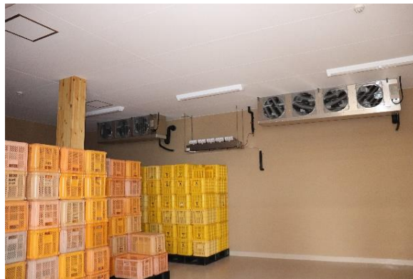
1F 冷温貯蔵庫
